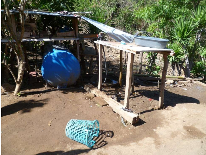
Fotografía 2.10 Tipo de Toma de Agua (medidor) Utilizado en las Viviendas del Barrio Tungani
